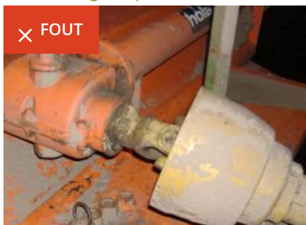
Afscherming niet compleet, kap ontbreekt
