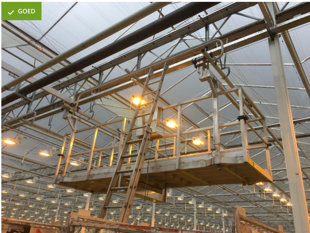
overgewaswagen met hekwerk
