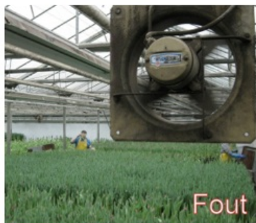
Onafgeschermd ventilator, laag geplaatst
