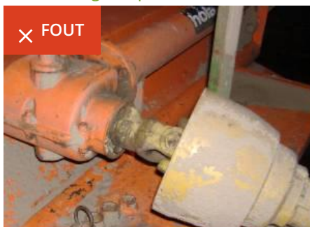
Afscherming niet compleet, kap ontbreekt
