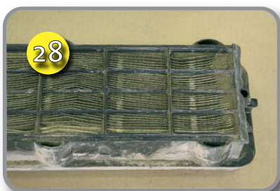
Dicht geslibd... achterstallig onderhoud
